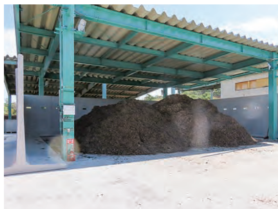
コーナー擁壁を活用した木材チップ保管施設
