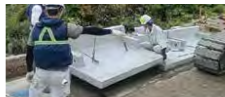
製品の設置状況
